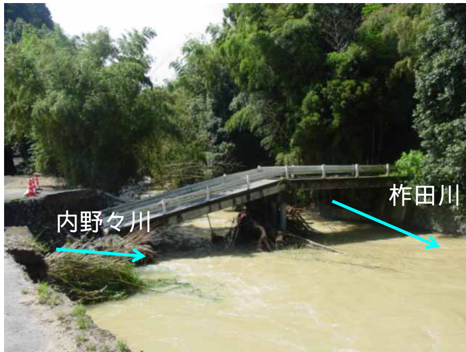
三豊郡大野原町五郷内野々 柞田川と内野々川の合流地点 町道橋落橋 8月25日 撮影
