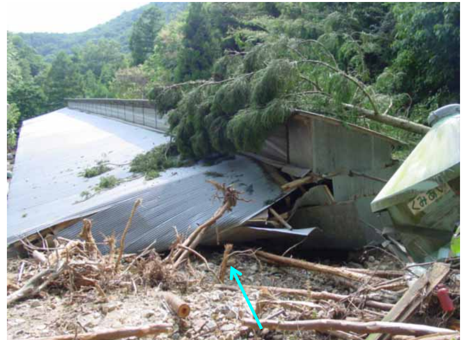
土石流危険溪流北峰川 鶏舎被災状況 8月25日 撮影
